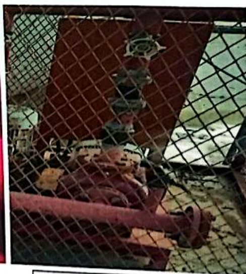
مضخة مياه عدد ١
